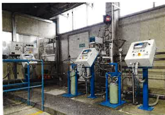
Impianto costituito da tre bilance collegate a un sistema Extrim e a un PC con software Matrix per il riempimento automatico di bombole
