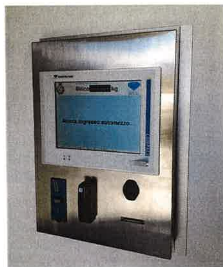
Impianto di pesatura self service con box contenente PC touch e software Matrix collegato in rete e possibilità di utilizzo tessere RFID o gettoni (installato presso il comune di Bagnolo Piemonte - CN)
